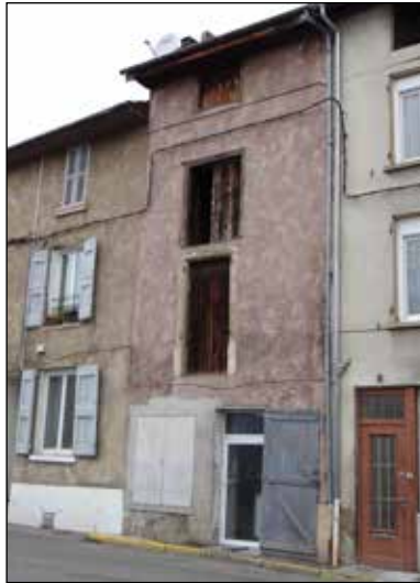
BEUREPAIRE - Bâtiments du tissu urbain ancien dégradés et vétustes
